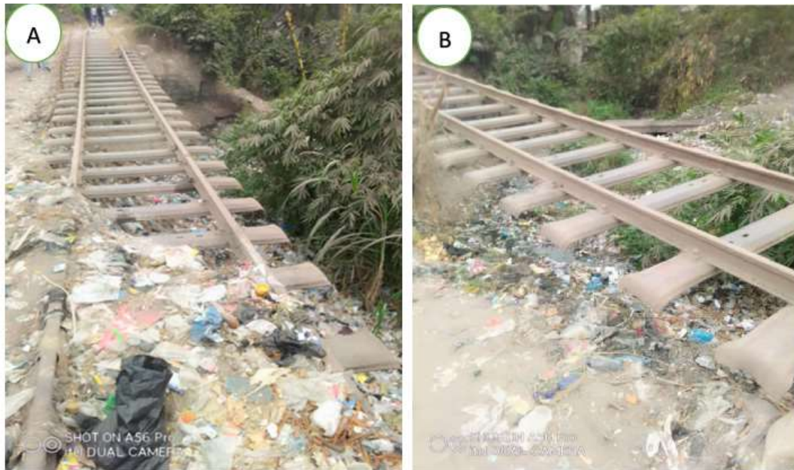
Figure 8 : Rails de train menacer 4°22'57.81"S/ 15°23'20.26"E
