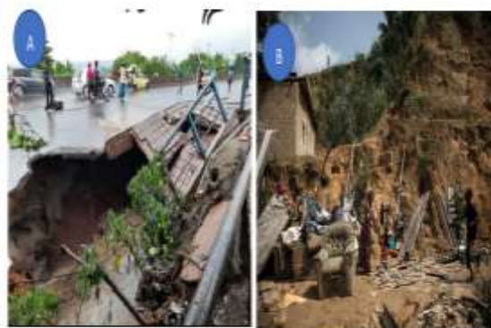
Figure 6 : Pont de la rivière NDjili endommagé (source : Newsglobe7 – L'info en toute simplicité 2021) b) Kinshasa, Mont Kitambo (Source, https://www.bbc.com/afrique 2018)
