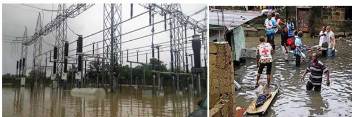
Figure 4 : Le poste haute tension de la SNEL sous eaux (source : www.mediacongo.net )
